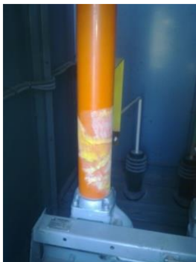
SLIKA 1 – OŠTEĆENA KOMORA 35 KV MALOULJNOG PREKIDAČA
